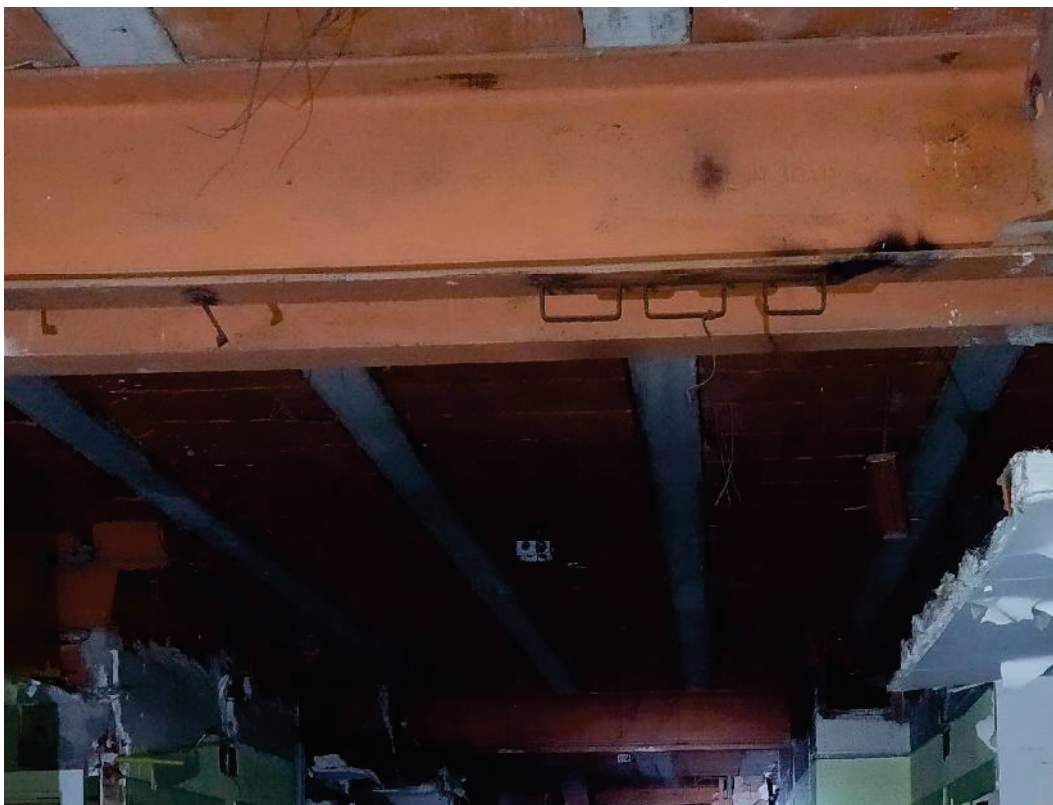
Foto: Les jàsseres sobre les que recolza el forjat unidireccional de biguetes prefabricades i revoltons ceràmics. En la visita realitzada a l'immoble s'ha apreciat que l'estructura metàl·lica de l'edifici no disposa de protecció ignífuga contra incendis.
