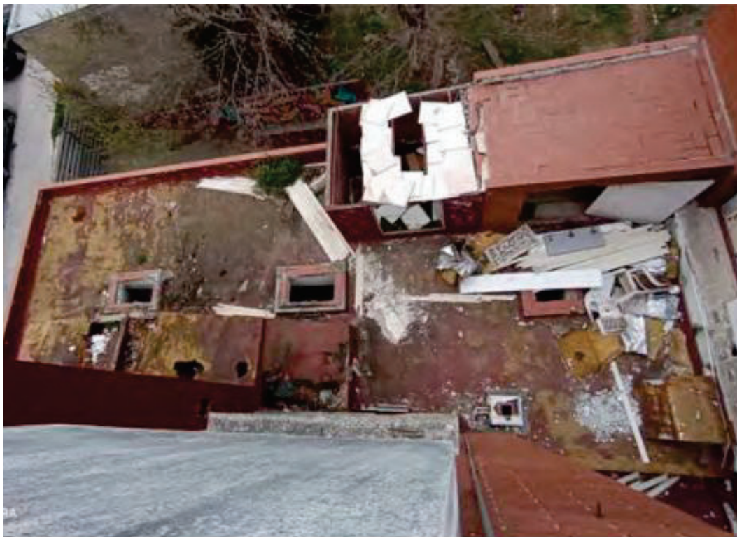
Foto: A la coberta del costat de la façana Nord (sostre pl. soterrani), les claraboies realitzades amb base de paret de maó ja no tenen els elements translúcids de PVC o vidre.
