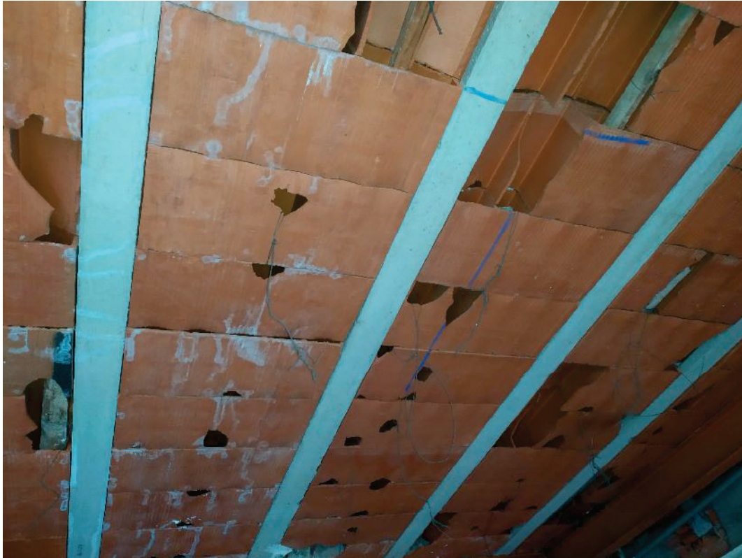
Foto: Part dels revoltons ceràmics tenen desperfectes a la cara inferior dels forjats sense que comprometin aparentment la seguretat de l'estructura.
